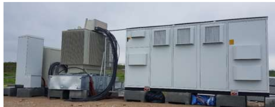
Figure 18 : Exemple d'onduleurs et transformateur installés à l'extérieur
