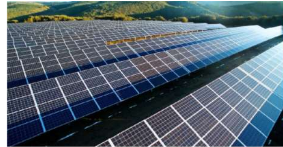
Figure 8 : Exemple de structure fixe (source : RES S.A.S)
