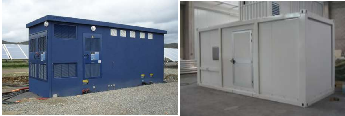
Figure 16 : Exemples d'onduleurs et transformateur installés dans des postes béton et containers
