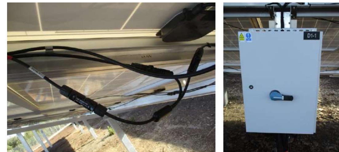
Figure 20 : Exemple de câble électrique et de boîte de raccordement (source : RES S.A.S)
